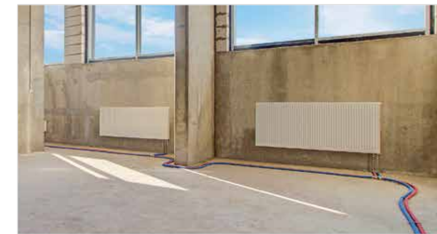
Горизонтальная разводка труб, радиаторы с нижним подключением и встроенными термостатическими клапанами
